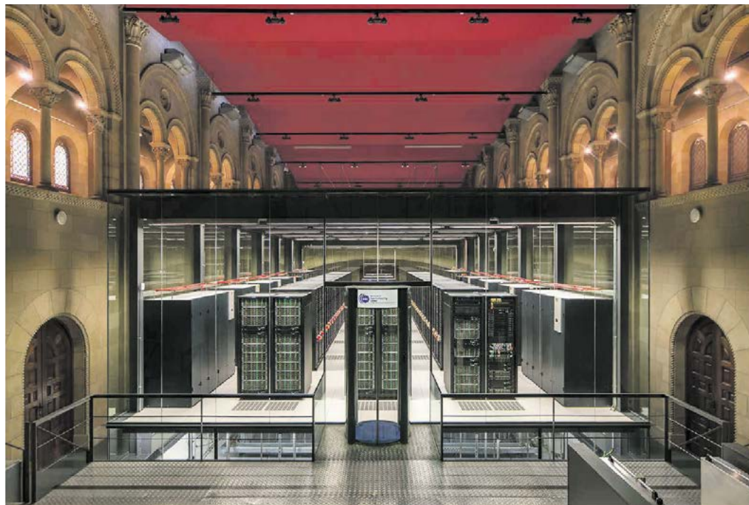
Das Rechenzentrum Barcelona mit dem MareNostrum 4 Supercomputer | © Barcelona Supercomputing Center
